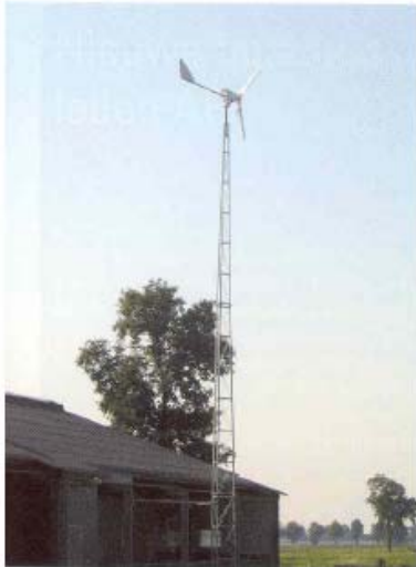
een urban windturbine van het type Fortis Montana
