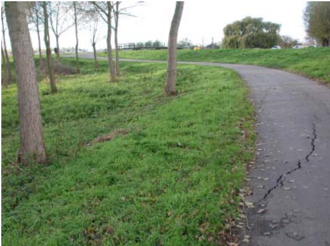
DSCN0642 NOORDKANT PIJNACKER NOORDKADE; OVERZICHTSFOTO BOMEN NABIJ SCHEUREN. KIJKRICHTING NAAR HET NOORDEN
