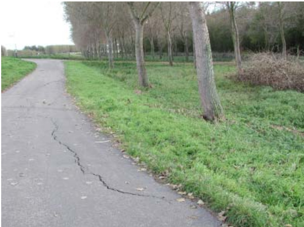
DSCN0643: NOORDKANT PIJNACKER NOORDKADE; OVERZICHTSFOTO BOMEN NABIJ SCHEUREN. KIJKRICHTING NAAR HET ZUIDEN
