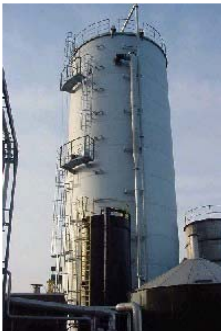
Figuur 8 UASB-reactor van Paques bij Kappa (Roermond)
