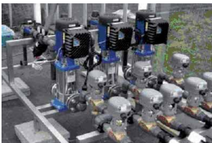
Figuur 5: Pompenset voor de Klimrek-scherminstallatie
