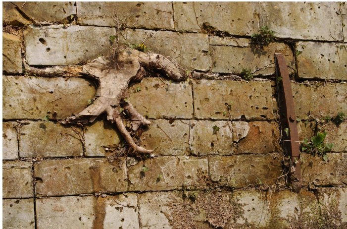
Figuur 7: Het effect van houtige begroeiingen op de kademuren. Door diktegroei wordt de muur uit elkaar gedrukt (foto: H. Jamin).
