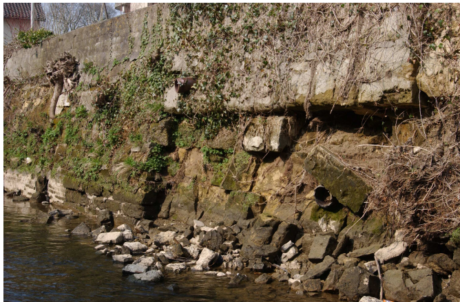
Figuur 1: Sommige delen van de kademuren in de Geultak bevinden zich in erg slechte staat (foto H. Jamin)
