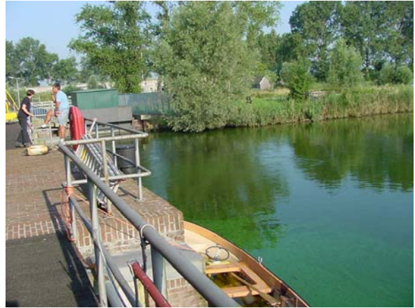
De uitstroom van gemaal in Spaarndam.
