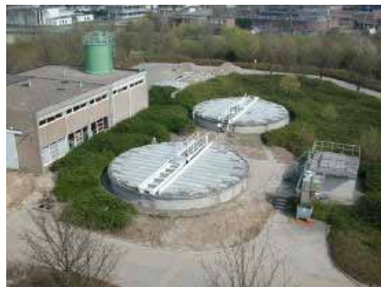
Rioolwaterzuiveringsinstallaties, zoals deze te Maastricht-Limmel, maken deel uit van de "waterketen"
