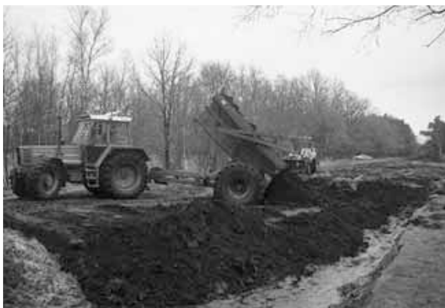
Het natuurlijk bergend vermogen kan worden vergroot door het dempen van watergangen en sloten zoals hier de sterk ontwaterende Klaasbergleiding. Foto: H. Dekker.
