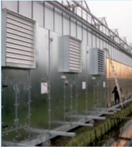
Wim Tas wil via de luchtbehandelingskasten gecontroleerd buitenlucht binnen laten.
