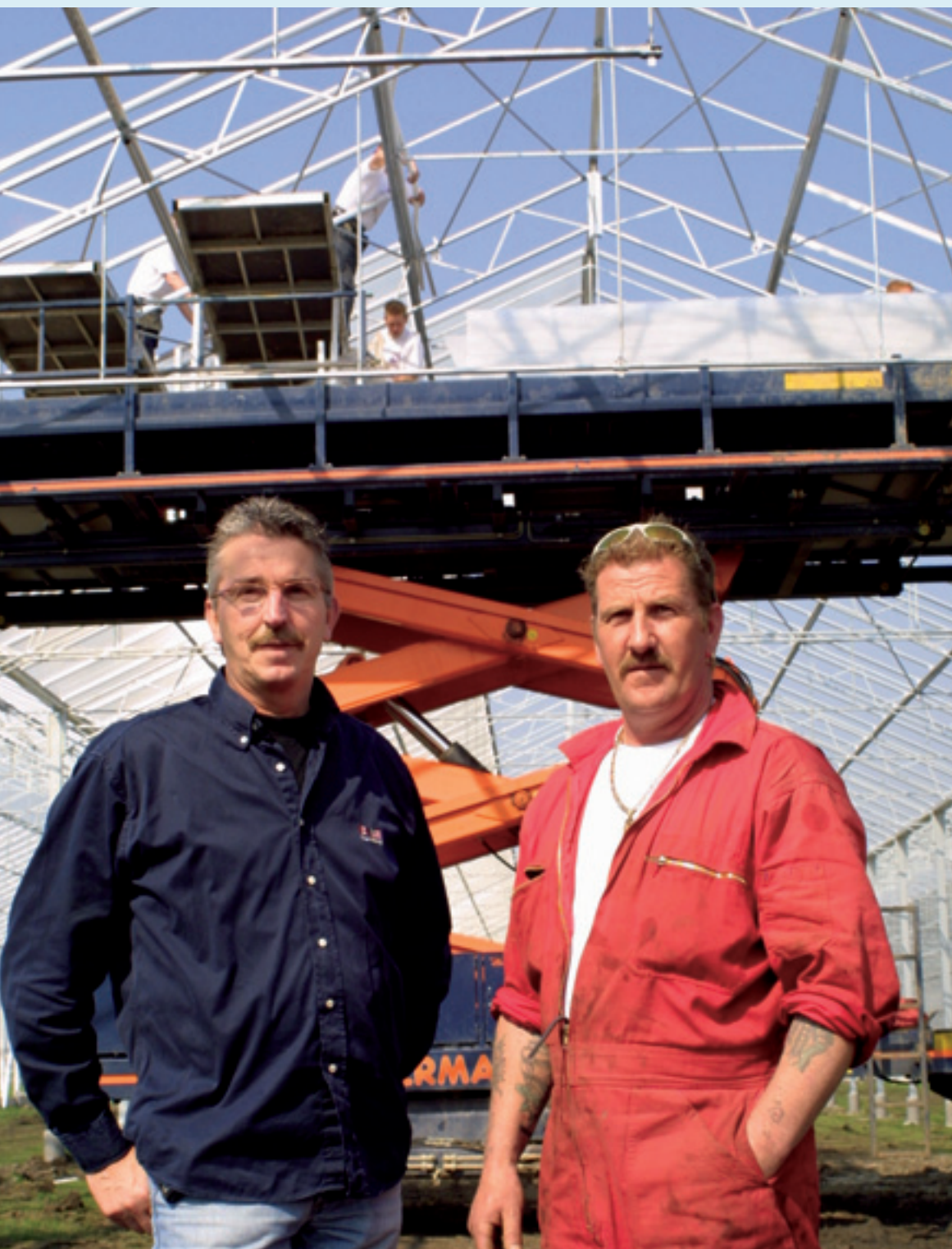
Onderaannemer Herman Batist (links) en voorman Jan Small: "Onze mensen staan dagelijks in de bagger en op de plank."
