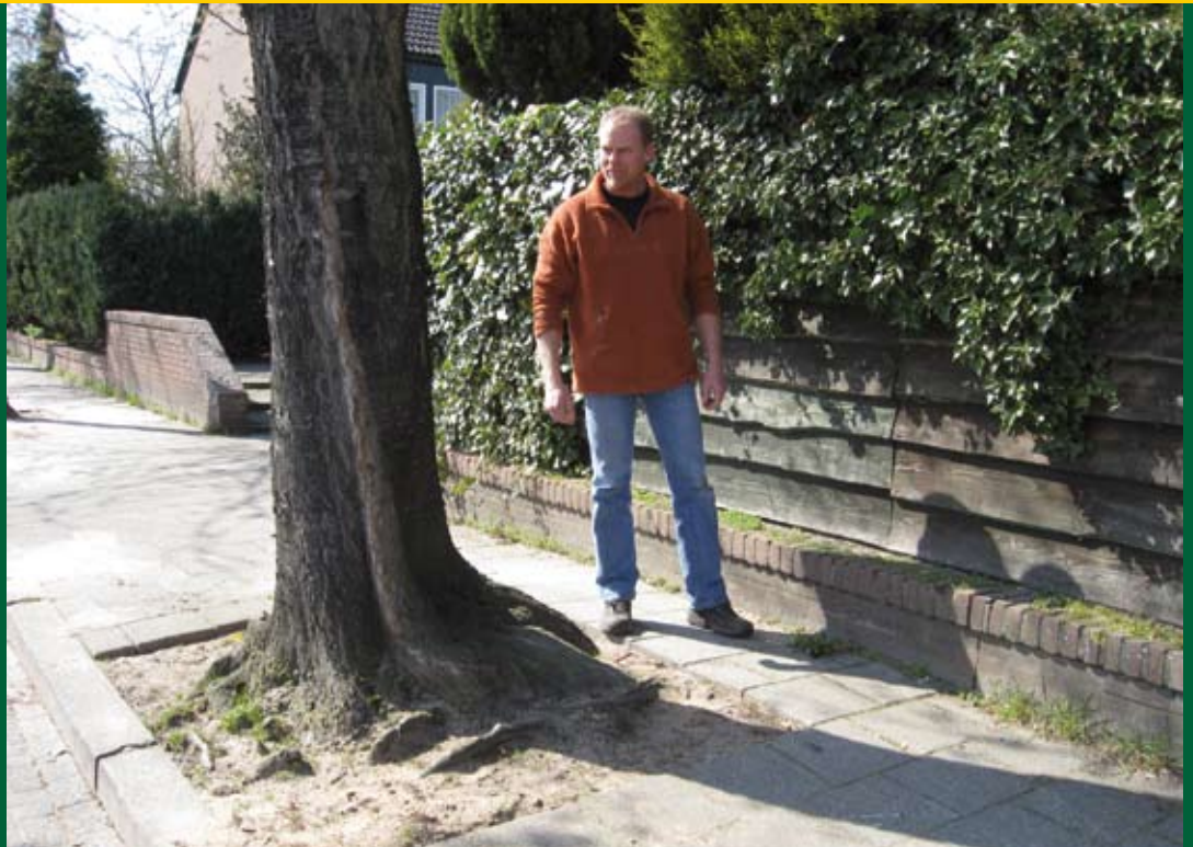
Erik Maten bekijkt de trottoirofdruk door boomwortels.
