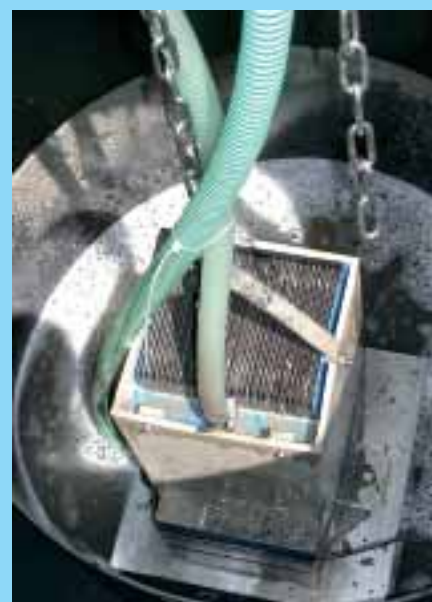
Membraanbioreactor voor zuivering van grijswater bij 'Arbeiten & Wohnen'.
