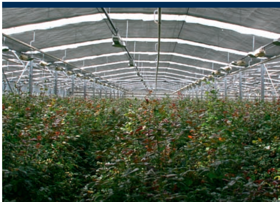
Bij Van den Broeck zijn alleen het doek en alle steun- en bovendraden vernieuwd. De installatie (de motor, as en trekdraden) waren nog in orde en zijn daarom niet vervangen.
