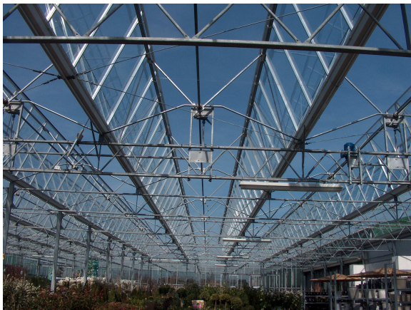
Dak uit de kassenbouw kan open en dicht
