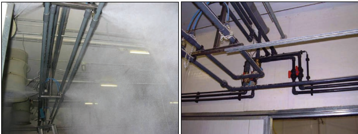
Figuur 3 Links: de originele twee olieleidingen met vier nozzles elk, boven het midden van de afdeling Rechts: het leidingwerk van lucht- en olieleidingen met kranen
