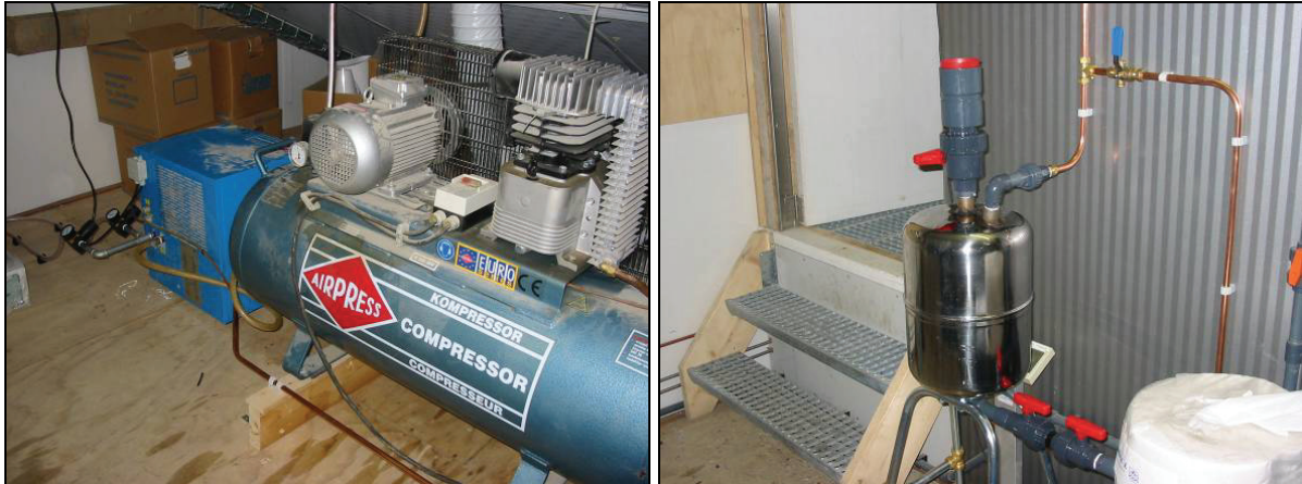
Figuur 2 Links: de compressor met luchtdroger Rechts: het oliedrukvat
