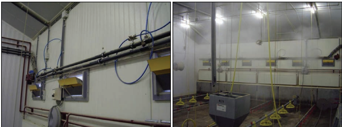
Figuur 4 Links: een bijgeplaatste olieleiding aan de zijwand Rechts: een bijgeplaatste olieleiding aan de zijwand tijdens het aanbrengen van de olie
