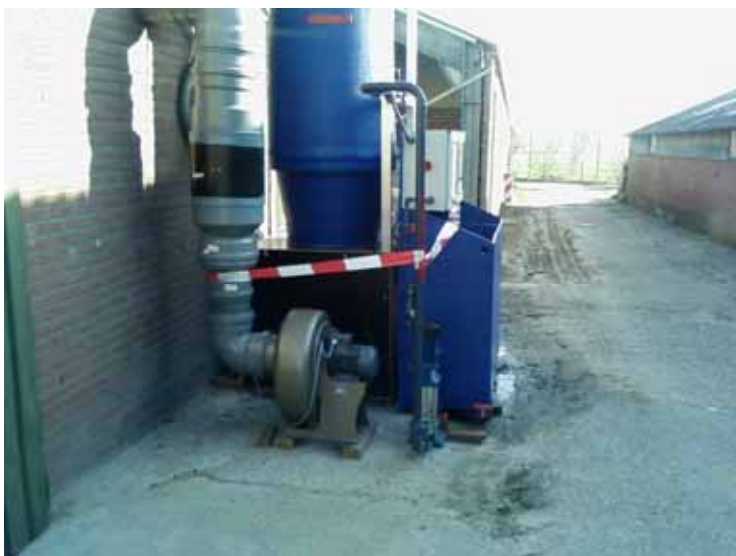
Foto: Zijaanzicht afzuiginstallatie buiten de stal
