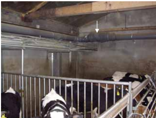
Foto: Op de achterwand (onder de witte pijl op de kopgevel) de verbinding van de verzamelbuizen van de linker en rechter stalhelft
