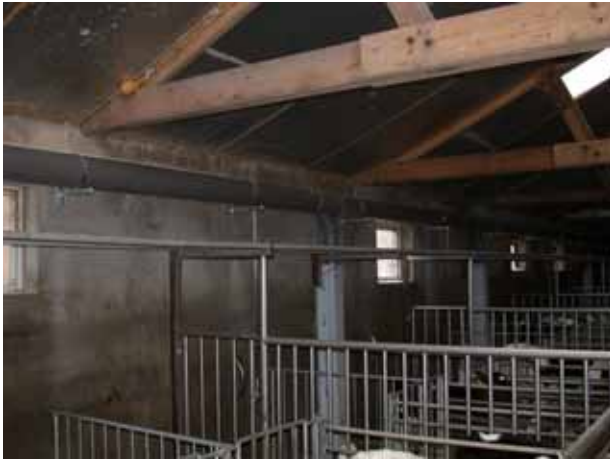
Foto: Stalimpressie met tegen de zijwand horizontaal (op ca. 2 m hoogte) de verzamelbuis van de kelderafzuiginstallatie en verticaal de aftakkingen (zie naar beneden wijzende pijtjes op de beschermmantel van de buis) naar de afzuigpunten onder de roosters
