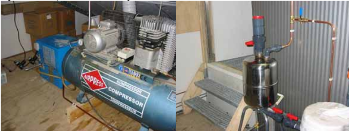
Figuur 2 Compressor met luchtdroger (links) en het oliedrukvat (rechts)
